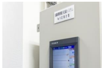
試験環境電子記録システム
