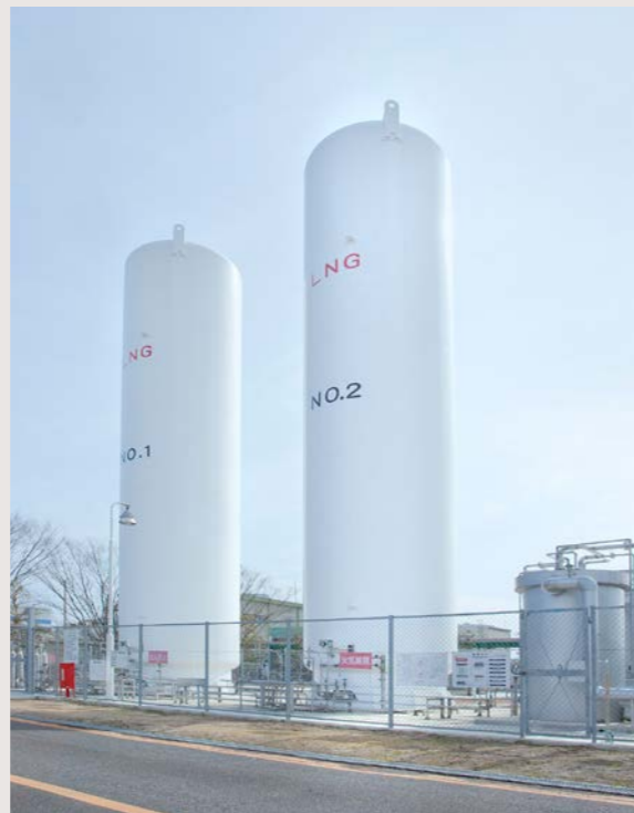
LNGサテライト施設と小型ボイラー施設
