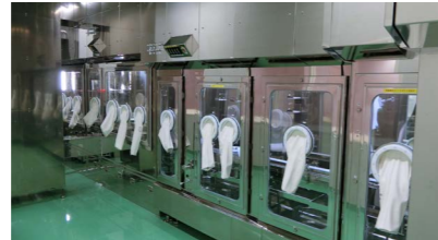
足利工場新注射剤棟 充填・凍結乾燥工程
