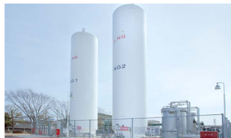
LNGサテライト施設と小型ボイラー施設
